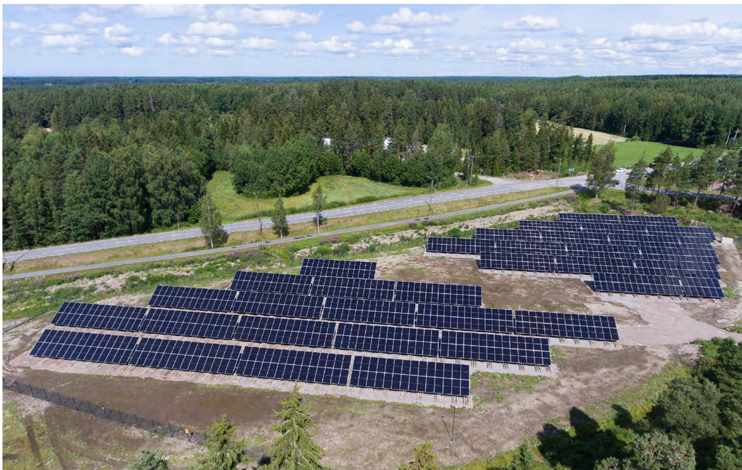
Solcelle park hos Coreplast Laitila Oy.
