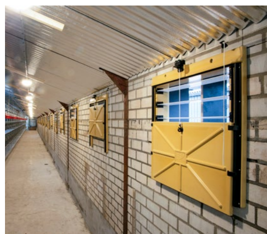
TPI Polytechnieks OmniFlux vægventiler installeret på en hollandsk fjerkræfarm
