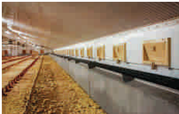
TPI's vægventiler i en kyllingestald
